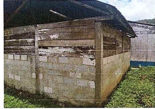
Foto 2: La cocina requiere repacion en toda su estructura
